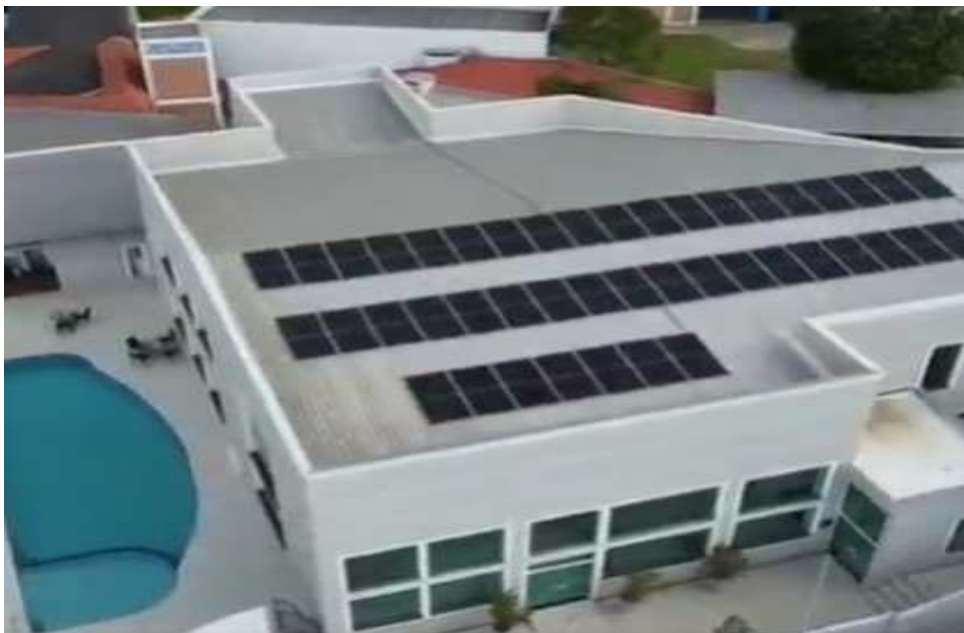
Sede social em santa felicidade com a instalação dos painéis solares.
